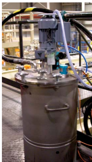
Adhesivo alimentando las válvulas dosificadoras desde un depósito
