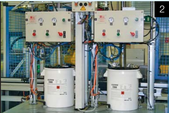
Conjunto doble de bombas DOPAG P30 con plato seguidor, con sistema de cambio automático, alimentan el adhesivo al punto de aplicación
